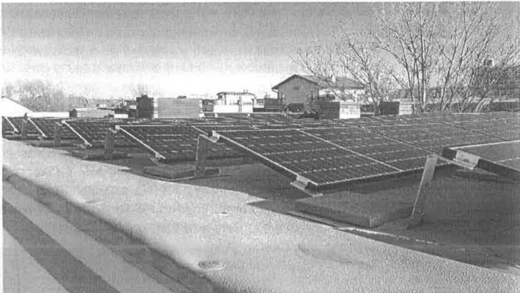
24. ábra: Napelemek a Barázda köz 9-13. iroda épület tetején
